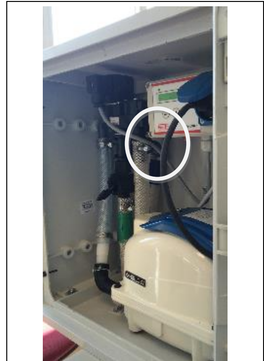
Conexión bombeo de agua tratada pegatina azul se conecta a salida trasera de la Válvula 4V.
