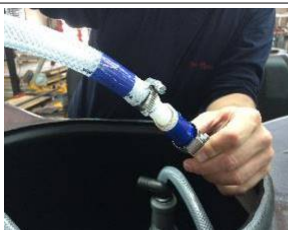
Conexión de la manguera que irá al cuadro eléctrico con la manguera del Air-Lift
