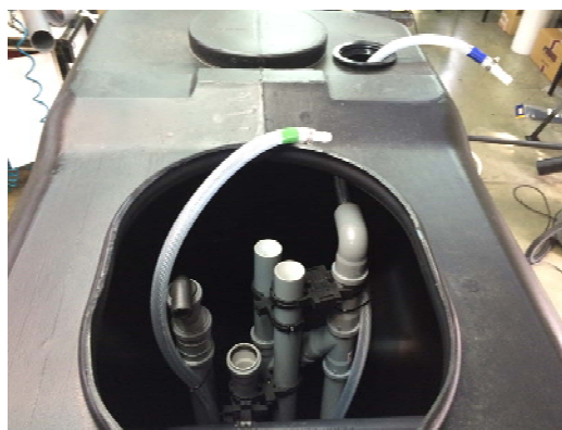
Sistema Air-lift instalado en el digestor clarificador. Vista de las mangueras neumáticas.
