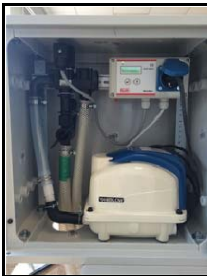
Imagen 5: interior cuadro de control de MS4
