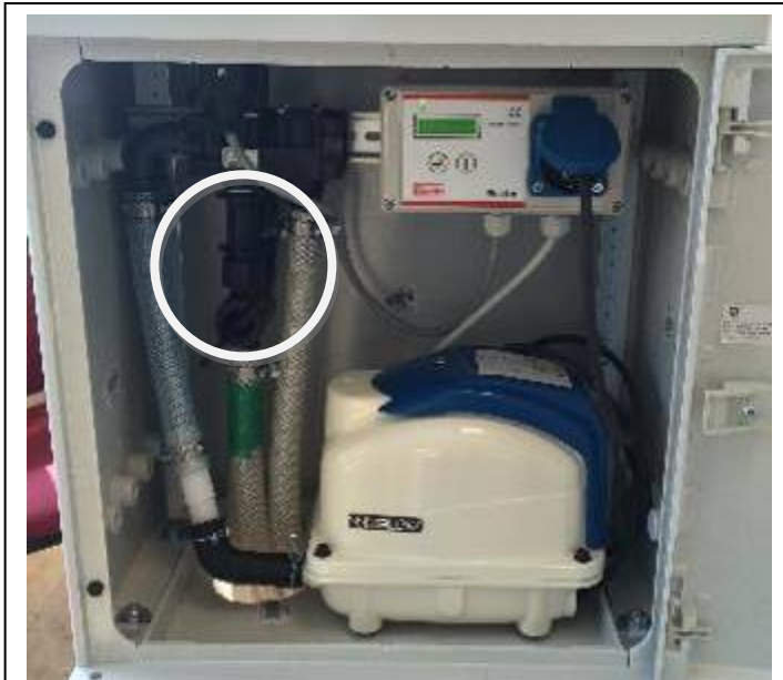
Conexión recirculación de lodos pegatina verde se Conecta a la salida inferior de la Válvula 4V.
